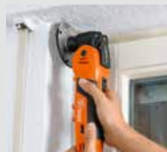
Distacco delle coperture di cassonetti delle tapparelle.
